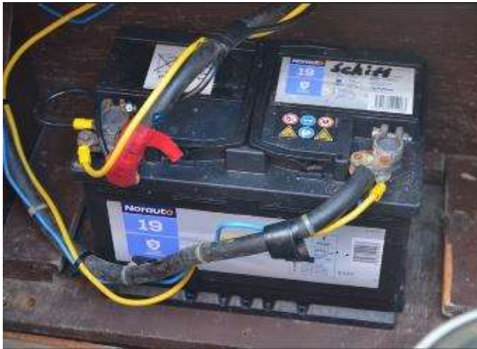
Batterie 12 V DC / 70 Ah Ladegerät im Motorraum
