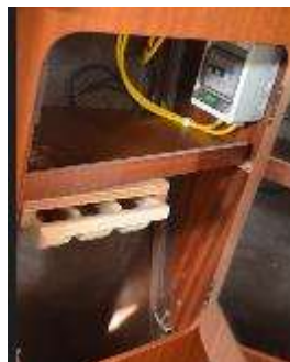
Sicherungskasten im Fach links im mittleren Bereich
